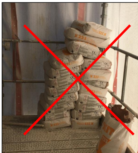
Fare for både nedfall av sekker og konstruksjonssvikt. 19 sekker á 25kg = 475kg!
